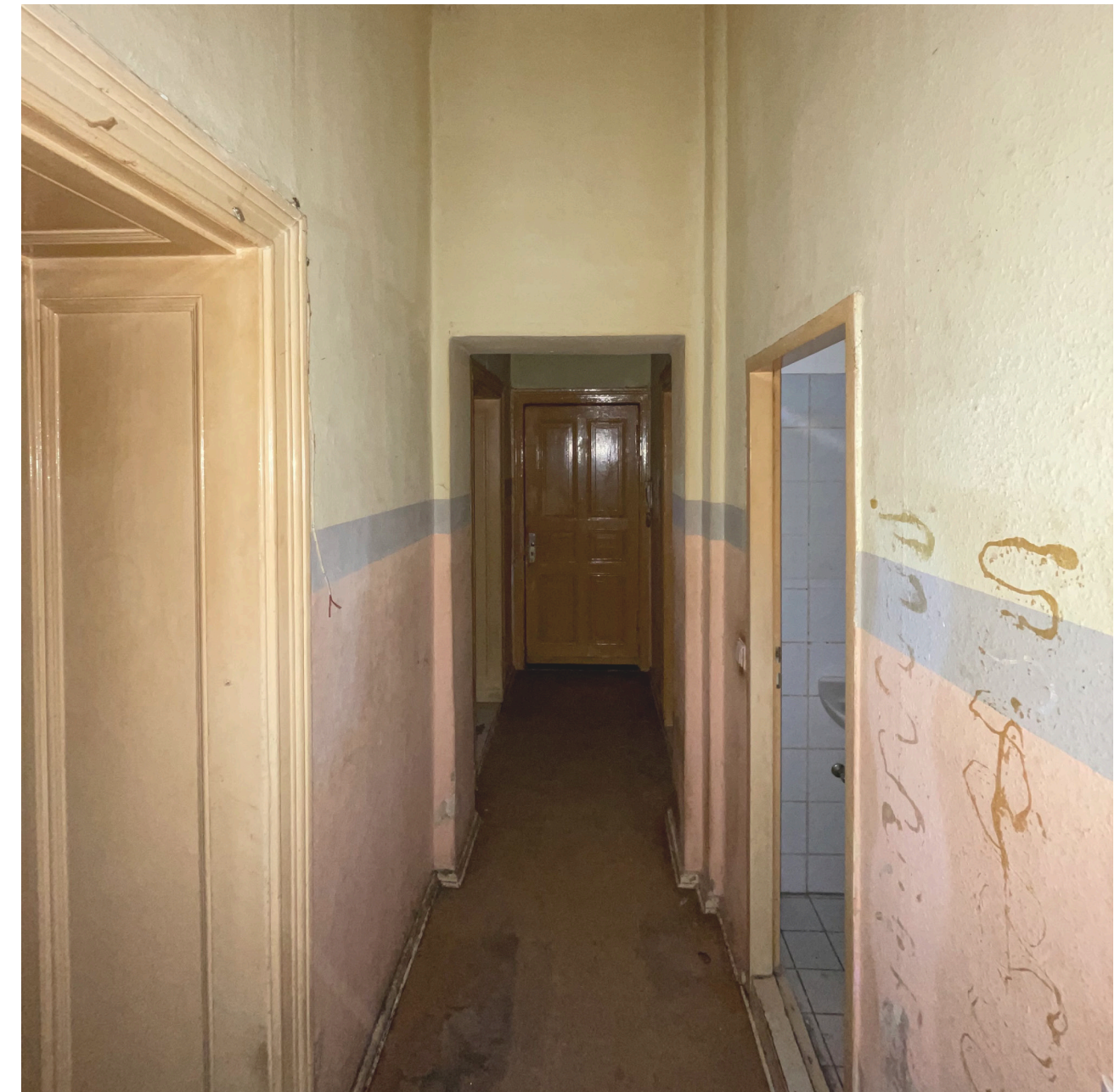
Hartnäckige Nikotinspuren im Wohnungsflur vor der Sanierung
